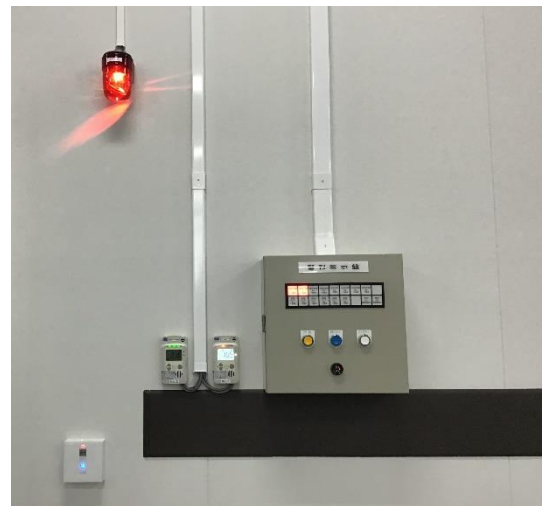
監視・警報システム
