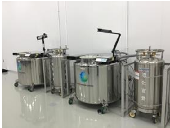
液体窒素を用いた貯蔵タンク
